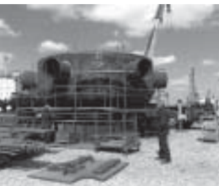
Piattaforma con serbatoi di varo.
